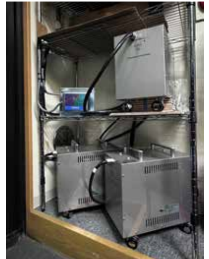
200V のトランスを 3 台使用している。
